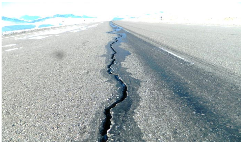
Рис. 3. А. Вид продольных трещин автодороги
